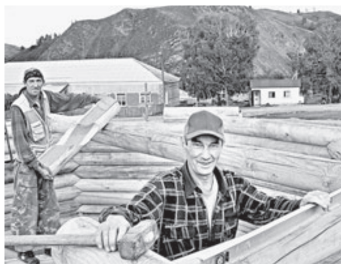
Строители работают даже в выходной день. Ведь особенно о новой церкви мечтают пожилые люди.
