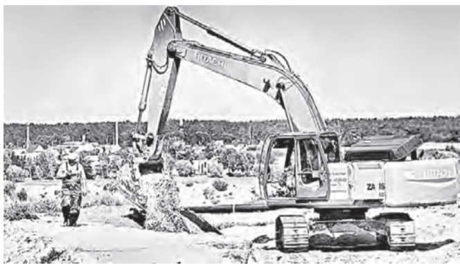
Работы выполнены только наполовину.
