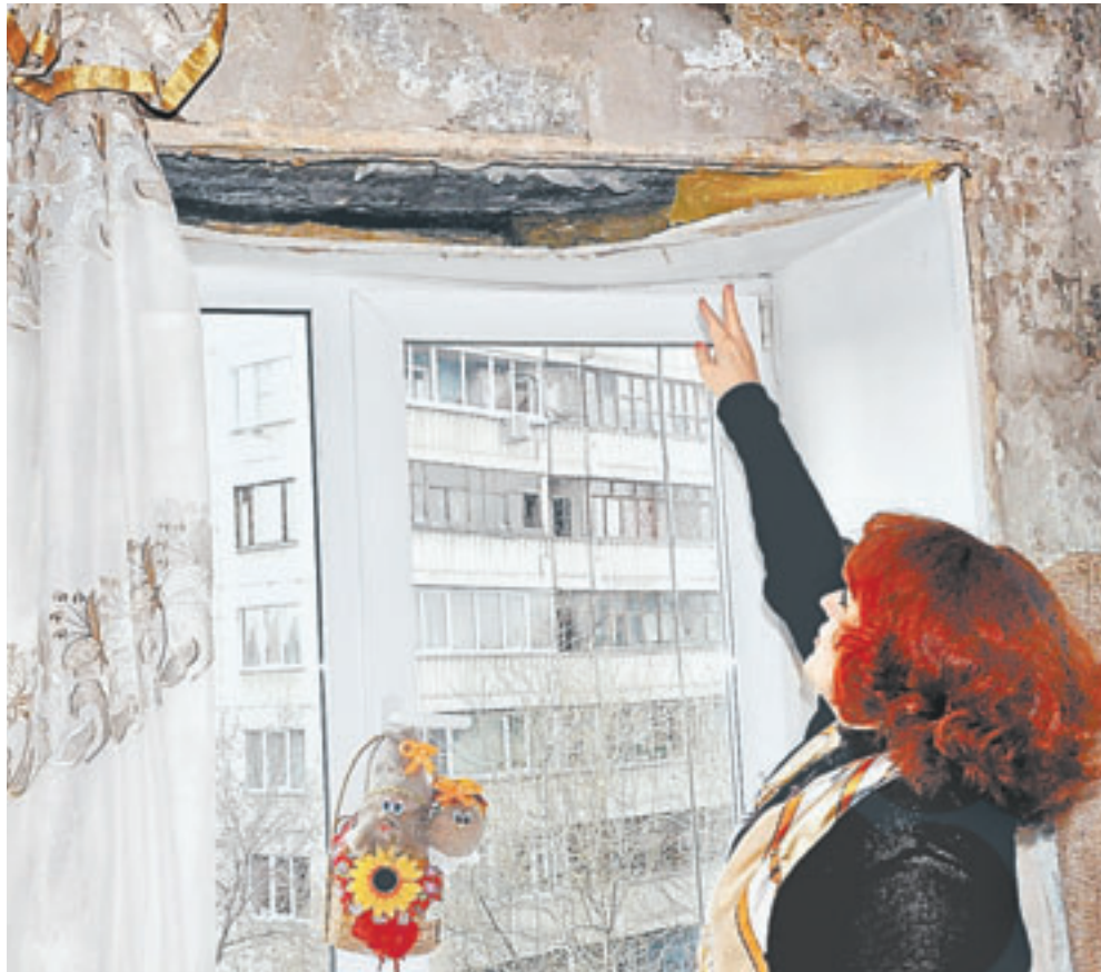
Татьяна Зобова демонстрирует последствия некачественного ремонта крыши.
