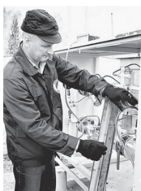
Начальник службы эксплуатации Алексей Вяткин на ГРП ведет наладку режима газоснабжения.
