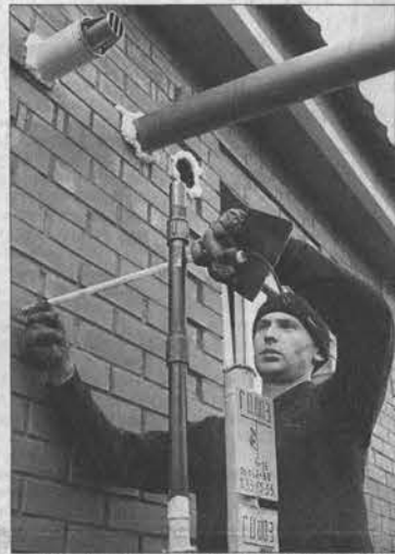
Монтажник газового оборудования компании-субподрядчика «Дева» Сергей Гордеев на ул. Советской: «Сегодня же планируем и закончить».
