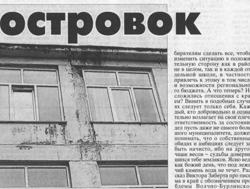
Следы подтопления видны и на фасаде.
