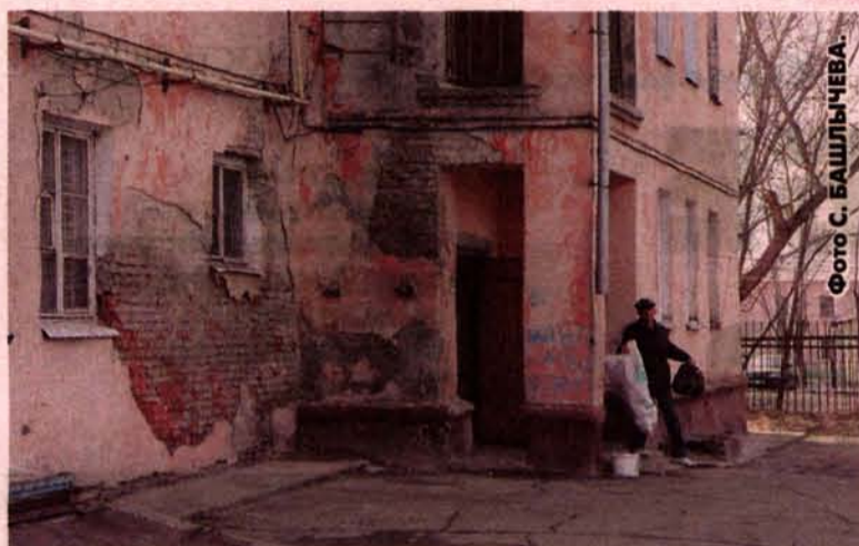
Жилье ждет своего ремонта.
