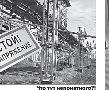
Что тут непонятного? Мастер подстанции Михаил Панасенко: «В недалекой перспективе подразумевается перевод управления техпроцессами подстанции на полную автоматiku. С видеонаблюдением за отдельными участками».
