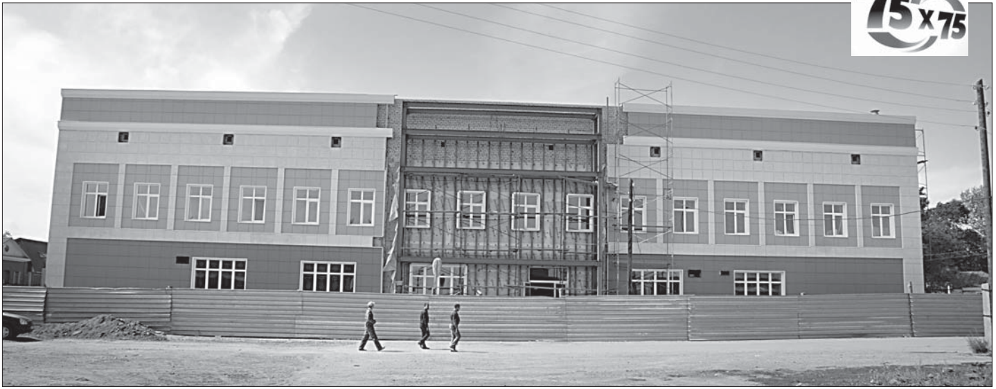
Возводит Дом культуры организация ООО «Строительное управление Алтайского моторного завода». Строители обещают сдать его уже нынешне осенью.
