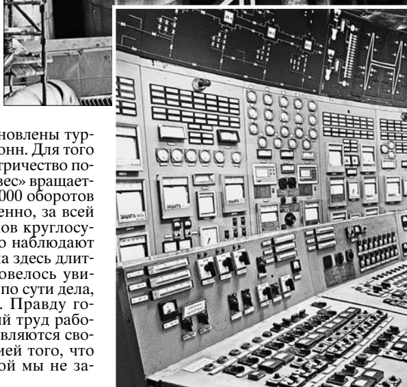
Центральный пульт управления - «сердце» тепловой станции.
