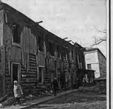
Дом явно не добавляет пейзажу красоты, а для соседних зданий он просто опасен – здесь уже дважды был пожар. Однако "лакомый участок" под точечную застройку почему-то никому не нужен. Может, на сносе деньги экономят – ждут, пока сам сгорит дотла?..
