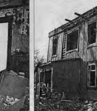
Дом явно не добавляет пейзажу красоты, а для соседних зданий он просто опасен – здесь уже дважды был пожар. Однако "лакомый участок" под точечную застройку почему-то никому не нужен. Может, на сносе деньги экономят – ждут, пока сам сгорит дотла?..
