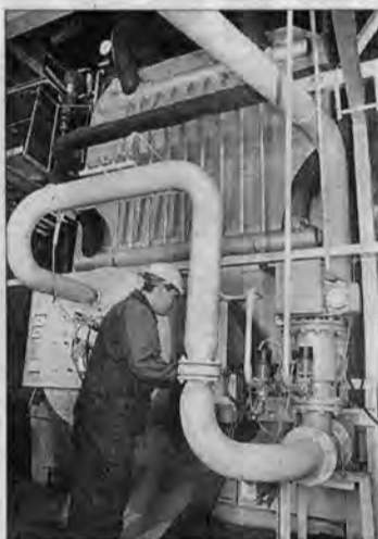
Второй газовый котел обеспечит теплом и завод, и поселок вокруг него.
