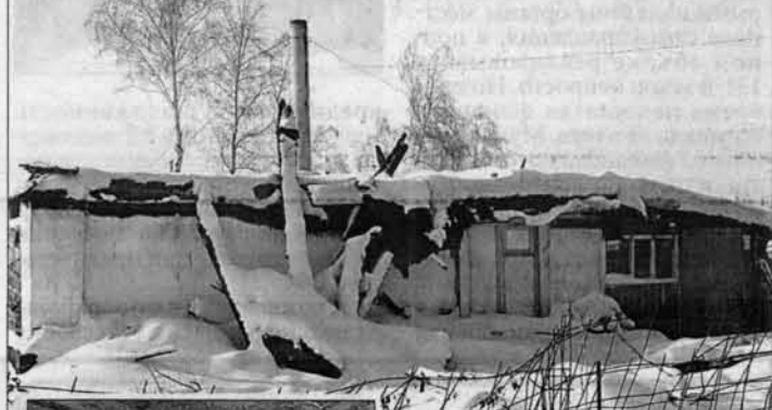
В задымленном доме кое-какая обстановка еще сохранилась, теперь от нее ничего не осталось. Насыпные стены, оставшиеся без крыши, продолжают оседать.
