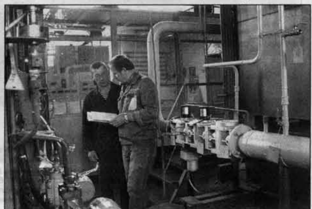
В Павловском районе на природный газ переведено 13 котельных. Эта котельная отапливает дома около 4 тысяч жителей Павловска.
