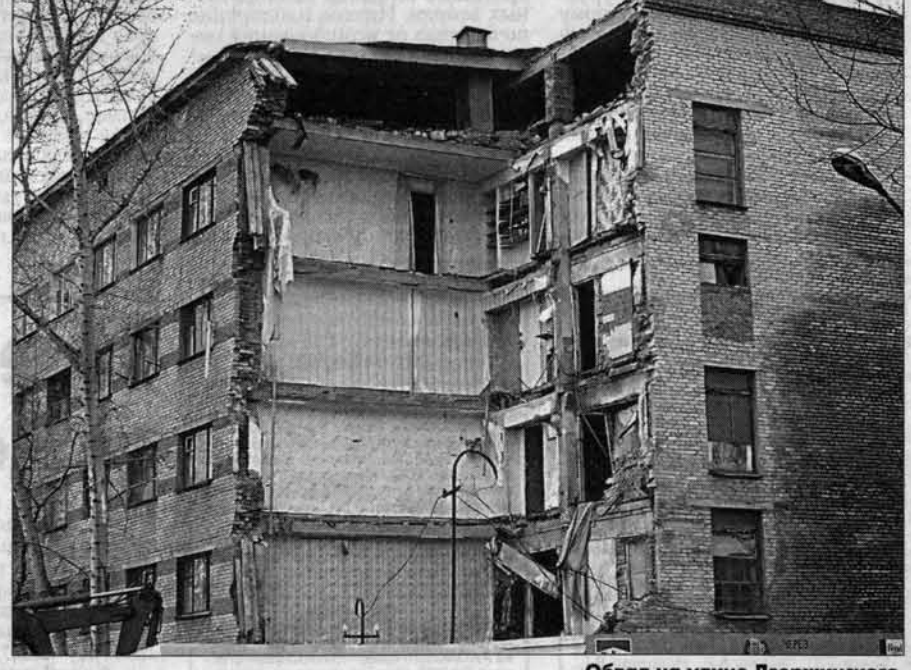
Обвал на улице Дзержинского.
