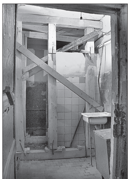
Эти распорки установлены в женском туалете - фактически только на них держится квартира второго этажа.
