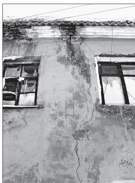
Эта трещина пронизывает насквозь стену квартиры N 24. Хозяйка квартиры Татьяна Аришина, чтобы избавиться от "вентиляции", извела на паклю целое одеяло.
