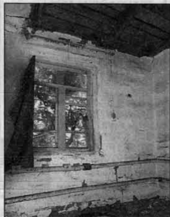
Комната, в которой обрушился потолок. Вверху просматривается крыша, внизу обломки свалившихся трухлявых досок и шпала.
