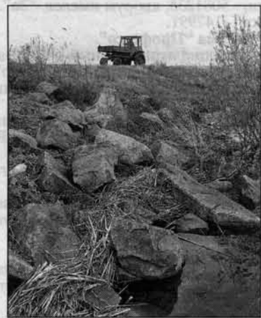
Горевское водохранилище. С одной стороны, плотину укрепляют, с другой - растаскивают камни.
