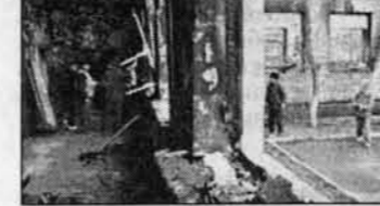
Якутская школа после пожара.
