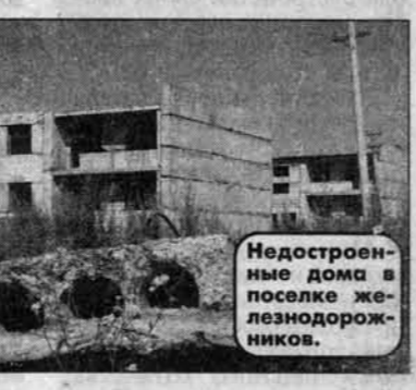
Недостроенные дома в поселке железнодорожников.
