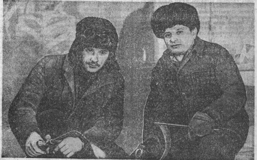
В машинно-тракторных мастерских колхозов и совхозов района продолжается ремонт техники. После сложной уборки прошлого года комбайны и тракторы требуют особенно тщательной подготовки. Быстро, не допуская простоев, выполняются любые задания сварщиков машинно-тракторной мастерской совхоза «Светлоозерский». В. В. Игнатов и слесарь А. П. Пономарев. К качеству выполненных ими работ нет никаких претензий. НА СНИМКЕ: сварщик В. В. Игнатов и слесарь А. П. Пономарев. Фото В. БЕДАРЕВА.
