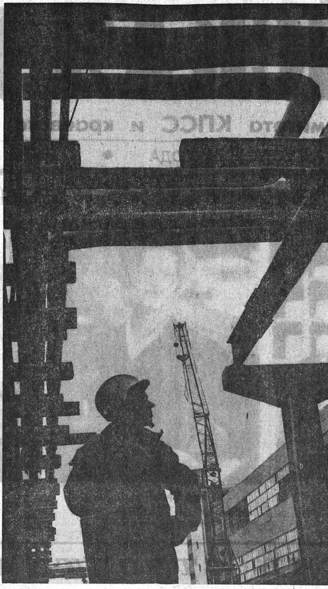
Стройка завода резиновых технических изделий. Эти мощные трубопроводы установлены барнаульскими монтажниками треста Сибметаллургмонтаж. Фото Э. Шлея.
