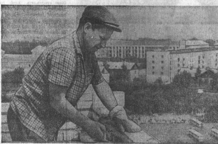
ОН СТРОИТ ГОРОД... Хорошо трудится в дни вахты в честь XXIV съезда партии каменщик третьего участка БСУ-4 треста «Барнаульскстрой» В. Г. Васильченко.
