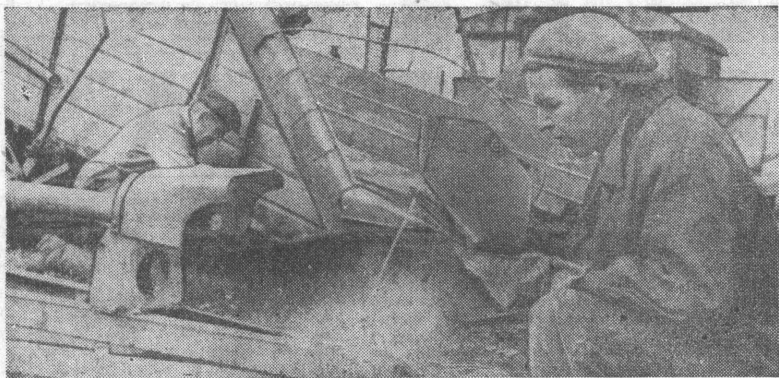
Механизаторы Повалихинского совхоза отремонтировали все зерновые и силосные комбайны. Сейчас завершается ремонт картофелеуборочных комбайнов и токов. Хорошо трудится на ремонте электросварщик Н. Т. Курятников, которого вы видите на снимке. Фото А. Калабухова.
