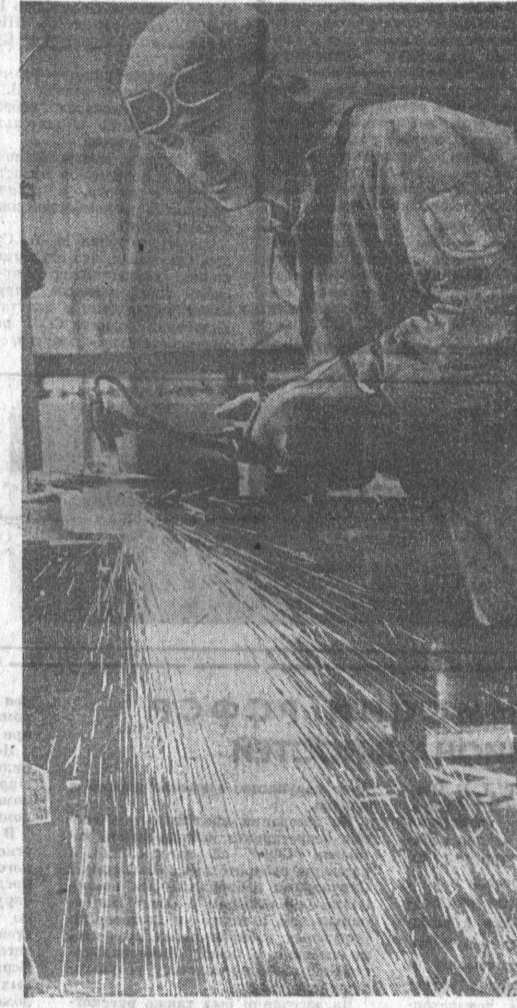
Газоэлектросварщик пятого участка Барнаульского монтажного управления треста «Сибметаллургомонтаж» А. А. Штанк, работающий на сборке оборудования цеха точного литья Барнаульского моторного завода, значительно перевыполняет производственные задания при отличном качестве работ.
