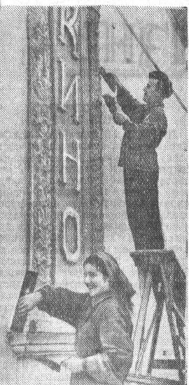
Хорошо трудятся в эти дни на отделе здания нового кинотеатра «Россия» в Барнауле штукатуры «Отделстрой» треста «Стройгаз» Анна Грищенко и Каря Милушкин.
