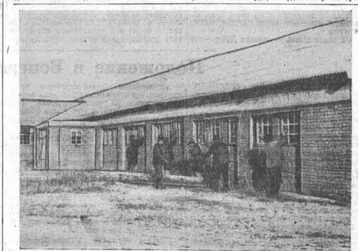
Колхоз имени Карла Маркса Шипуновского района строит сейчас одновременно несколько животноводческих помещений. На снимке: на строительстве четырехрядной коровника в колхозе имени Карла Маркса.
