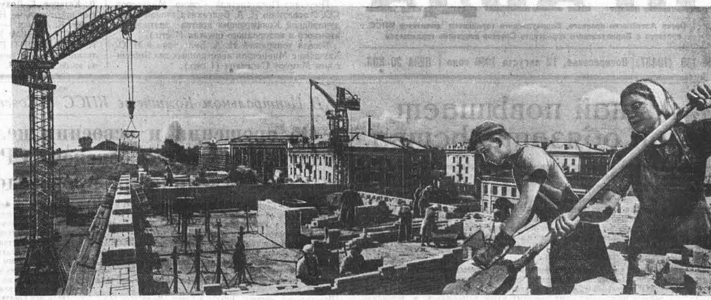
На строительстве 144-квартирного жилого дома в г. Барнауле. Здесь будут жить рабочие хлопчатобумажного комбината. В нижнем этаже здания разместятся автоматическая телефонная станция, большой детский сад и кафе. На снимке: общий вид дома. Работы ведет комплексная бригада П. Е. Лапина. Справа — каменщик Валерий Ветров и подсобная работница Таня Носырева, занявшие первое место в социалистическом соревновании. Фото Н. Калинин.
