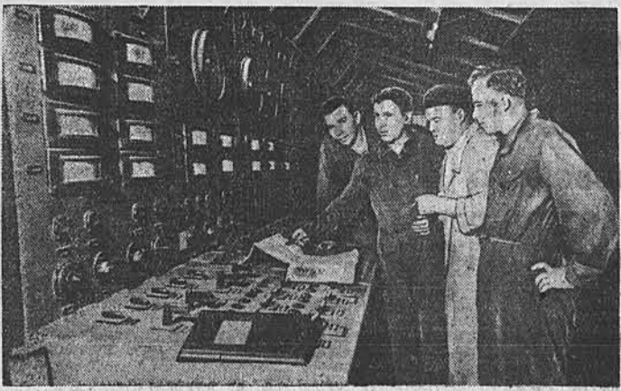
В Варшаве заканчивается строительство первой очереди крупнейшей в Польской Народной Республике теплоэлектростанции «Жерань». Она сооружается по советским проектам и полностью оснащается советским оборудованием. В монтаже теплоэлектростанции принимают участие советские специалисты. На снимке: советские специалисты С. Хаценко и Г. Краченко, польский инженер А. Ковальский и начальник смены С. Денкевич у пульта управления.
