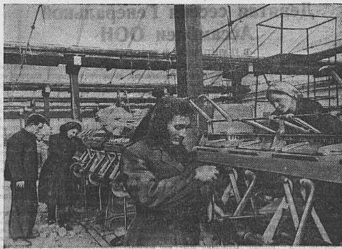
На прядильной фабрике Барнаульского хлопчатобумажного комбината полным ходом идет монтаж оборудования. На снимке: бригада М. Д. Бычковой монтирует ленточные машины. На переднем плане — комсомолец инженер Мария Картава за сборкой ленточной машины. Фото П. Хоррина.
