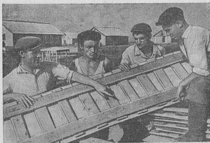
На строительстве жилых домов в зерносовхозе «Алтай». На снимке (слева направо): бригадир Николай Мартынов и члены бригады Сергей Ланин, Владимир Белый и Борис Тимошенко за осмотром деталей для сборки очередного дома. Фото В. Николаева.
