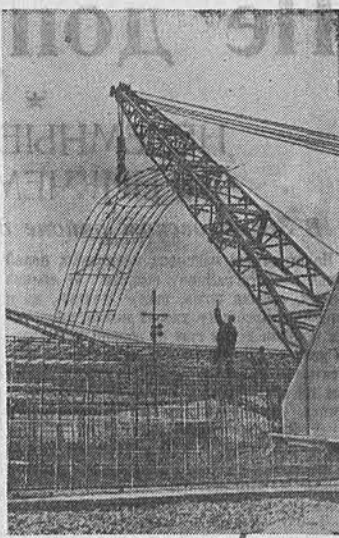
СТАЛИНГРАДСТРОЙ. В котловане ГЭС и водосливной плотинки развернулись бетонные работы. Одновременно с укладкой бетона в фундаментные плиты ведется установка железной арматуры. На снимке: монтаж арматуры. Фото А. Маклецова. (Фотохроника ТАСС).
