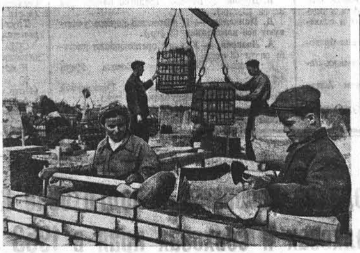
Первое стройуправление треста «Стройгаз» скоростными методами ведет по проспекту Ленина в Барнауле сооружение 80-квартирного жилого дома. Среди строителей высочайшей производительности добилась бригада каменщиков, руководимая И. Г. Чабан. Ее постоянная сменная выработка — по четыре нормы.
