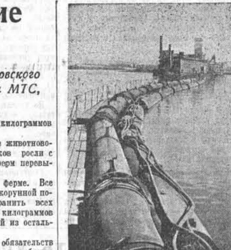
НОВАЯ КАХОВКА. 35 тысяч кубических метров грунта в час вынимают землесосы, работающие в Днепровской пойме. По-сталиновски трудится экипаж земснаряда «1000-80». Вынимают грунт из котлована под здание гидроэлектростанции, но значительно опережает темпы работ. НА СНИМКЕ: сверхмощный земснаряд «1000-80». Фото А. Фатеев. (Фотокорреспондент ТАСС).
