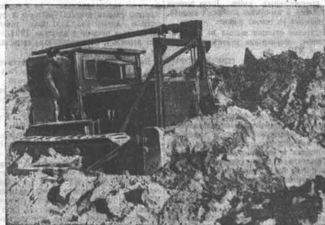
На строительстве Южсбы широко применяются мощные дорожные механизмы. На снимке: бульдозер, которым управляет один из передовых механизаторов стройки тов. И. Еланский. Его выработка до двух норм в смену. Фото Н. Суворовского.
