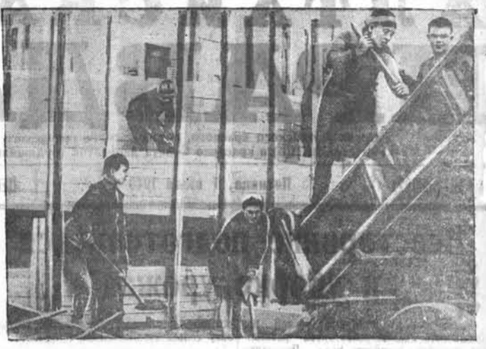
На строительстве водонасосной станции в посёлке Алтайского тракторного завода имени М. И. Калинина по-стахановски работает коллектив бетонщиков тов. Самардина. Свои задания бетонщики систематически выполняют на 112 процентов и выше. НА СНИМКЕ: члены бригады бетонируют фундамент. Фото М. Литинского.
