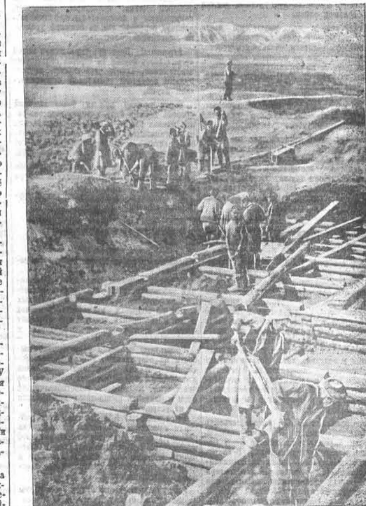
Колхозники сельхозартели «Мухор Гархата», Кош-Агачского аймака, решали к 15 июля закончить строительство электростанции мощностью в 50 киловатт. НА СНИМКЕ: строительство турбинной камеры для гидростанции. Фото Н. Калинин.
