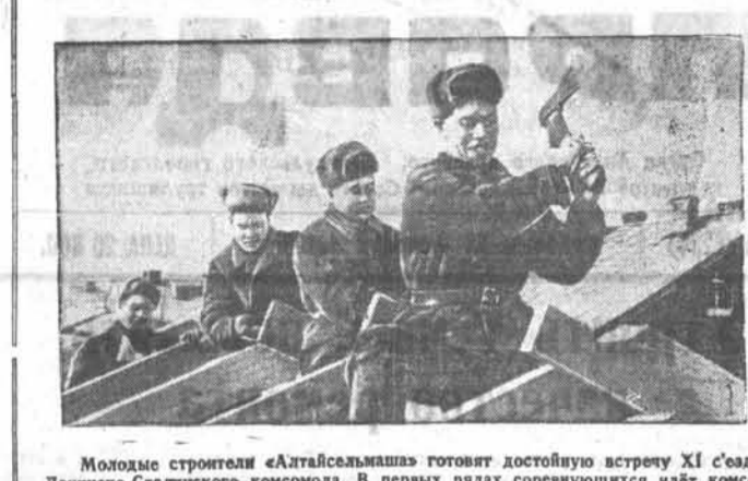
Молодые строители «Алтайсельмаша» готовят достойную встречу XI съезду Ленинско-Сталинского комсомола. В первых рядах соревнующихся идёт комсомольско-молодёжная бригада плотников В. Кижакина. Молодые плотники ещё в сентябре выполнили программу 1948 года. 150—180 процентов задания — такой ежедневный результат их работы.
