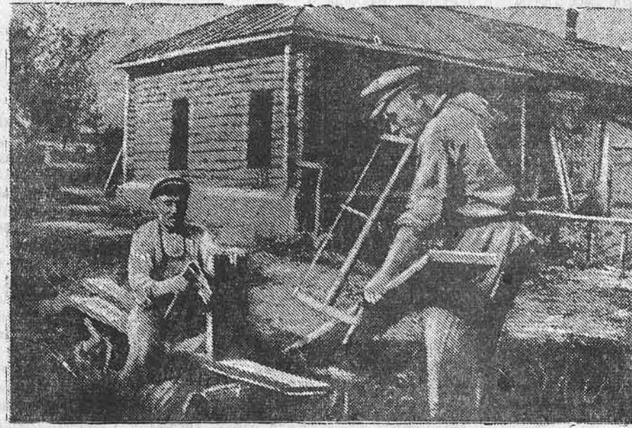
Колхозники артели «Единство», Ефремовского района, Тульской области, строят в этом году новую начальную школу, являе большую прежней, сооруженной немцами захватчиками. НА СНИМКЕ: плотники Е. А. ЧЕРНЫШЕВ (слева) и Е. В. ГЕРАСИМОВ за работой на стройке. Фото П. Лисенкина. (Фотохроника ТАСС).
